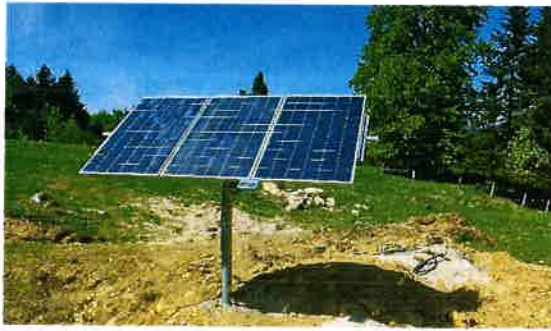
Panneaux solaires de la pompe
